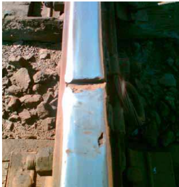
Рис. 1. Выкрашивание металла в принимающем рельсе в зоне стыка на одном из участков Транссиба (пропущенный тоннаж — 420, 2 млн т)
